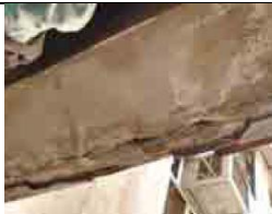
Spalling 石屎剝落
