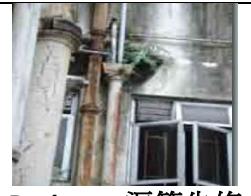
Drainage 渠管失修
